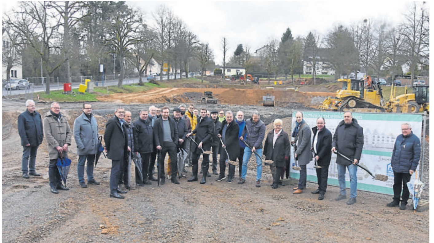
Beim symbolischen ersten Spatenstich auf dem alten Kirmesplatz sind im Hintergrund bereits die Anfänge der Bauarbeiten für das neue Seniorenzentrum „Lindenring“ zu sehen. Foto: Margit Bach
