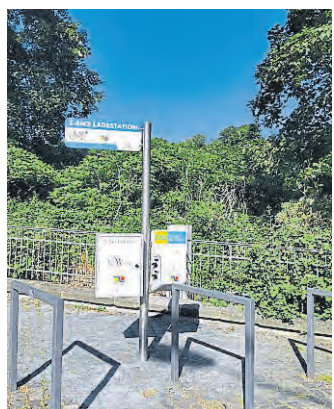
Die zweite Ladestation ist in Betrieb. Foto: Stadt Weilburg
